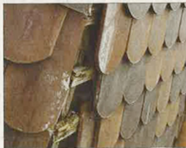
Die morschen Dachlatten sollen rasch ersetzt werden.
